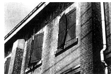
爆風により変形した鉄扉
